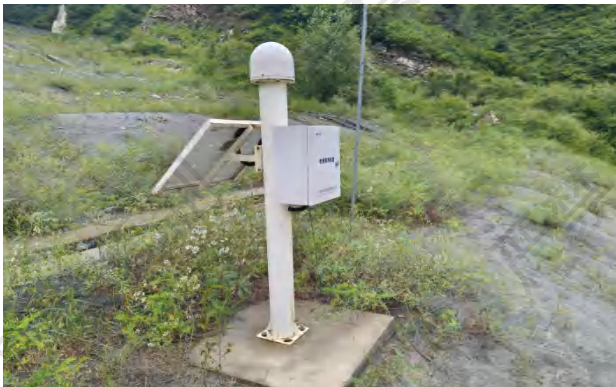
图 2.4-14 在线位移监测设施
