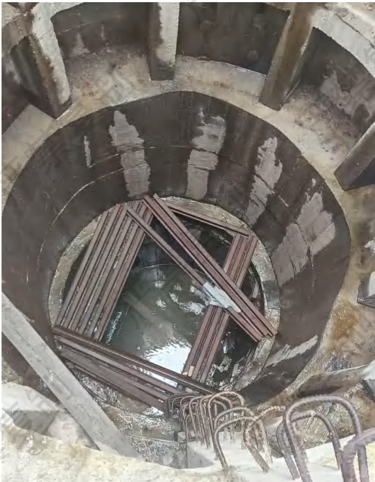
图 2.4-9 4号排水井加固现状
