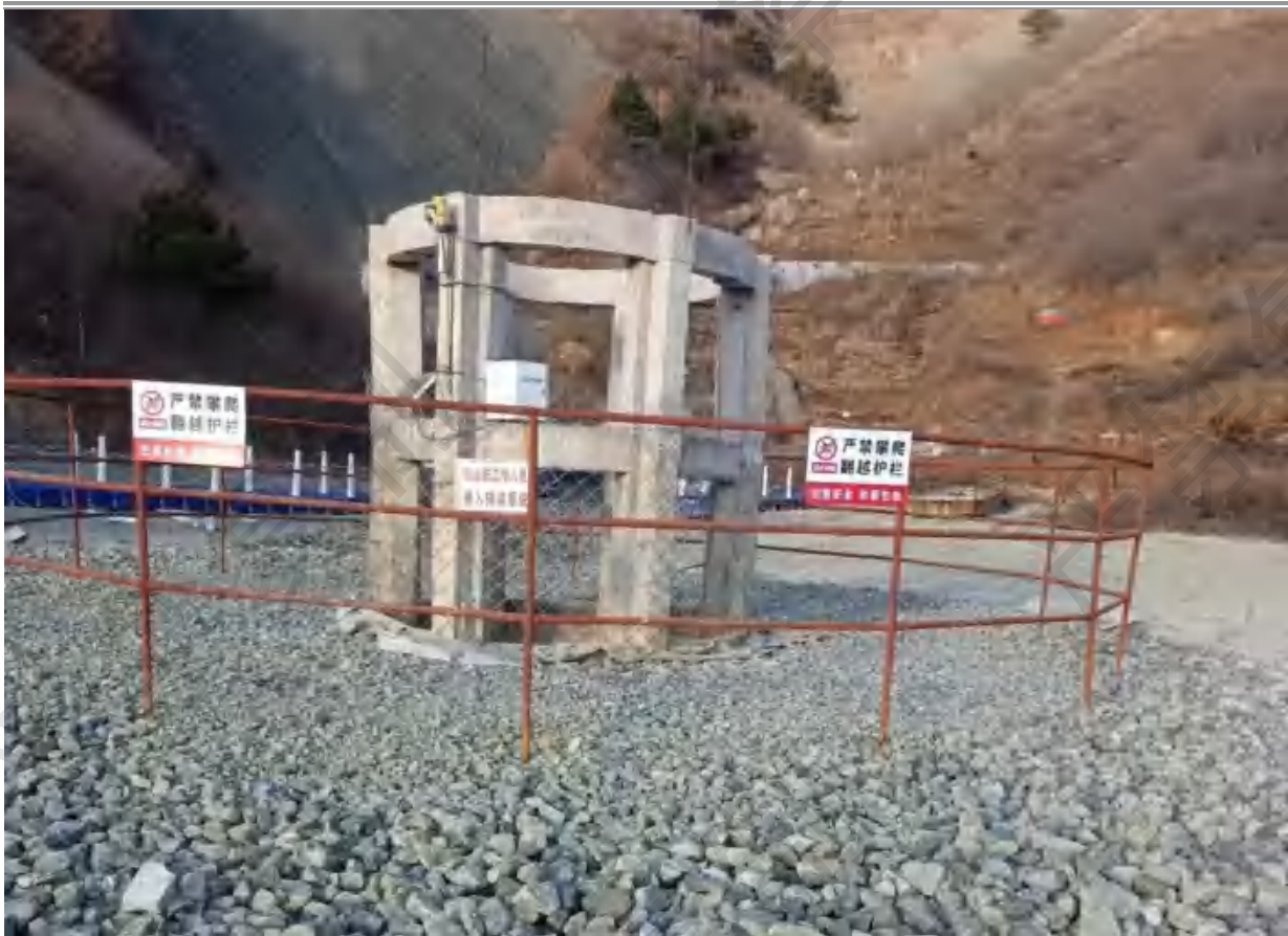
排水井周边防护设施
